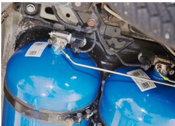
CNG wird bei 200 bar gespeichert.
