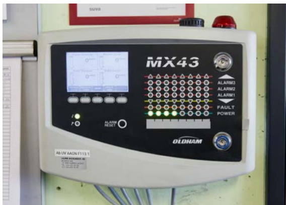
Gaswarnanlagen warnen vor explosionsfähigen Gaskonzentrationen.
